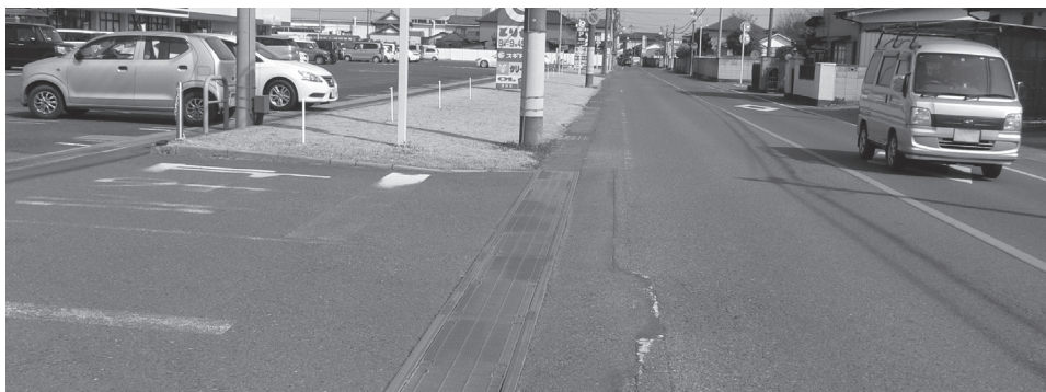
外側線が消えかけている町道3号線
