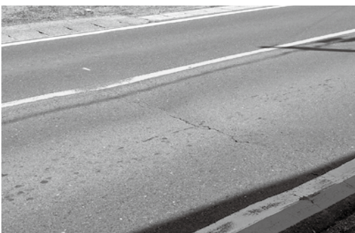
県道20号線の損傷状況（ウエルシア東付近）
