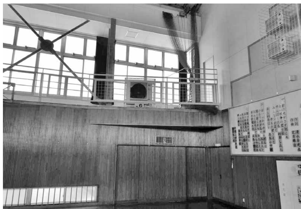
学校環境改善事業で全小学校の体育館にエアコンが設置された
