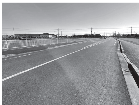
外側線が消えかけている町道 19 号線
