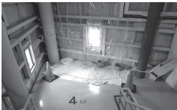
雨漏りが続くタワー内部
