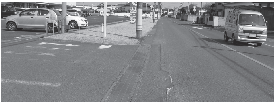
外側線が消えかけている町道3号線
