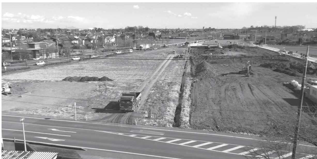
地域の人の生活や農業促進の拠点として期待される生活拠点施設整備事業の工事中の現場（邑楽南中学校東）
