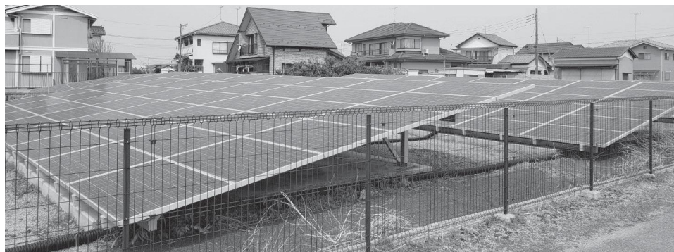
住宅地内に設置されている太陽光発電施設
