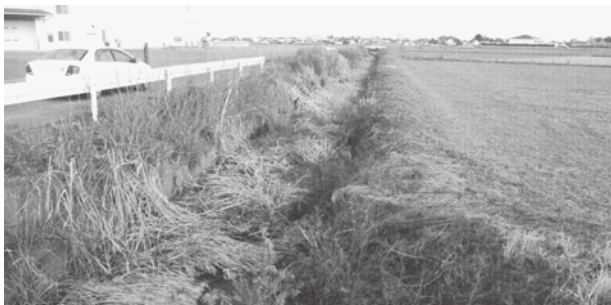
草が繁茂する排水路
