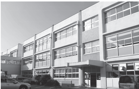
北校舎の老朽化が見受けられる邑楽中学校
