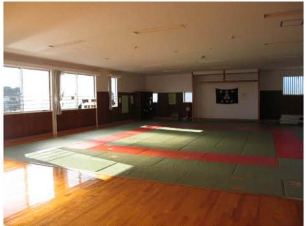
⑦ B通り、1通り 鉄骨ブレース、 屋根ブレース設置後（2階柔道場）
