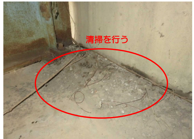
沓座土砂堆積の清掃
