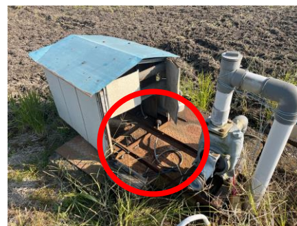
盗難されたポンプ小屋
