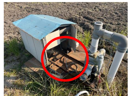
盗難されたポンプ小屋
