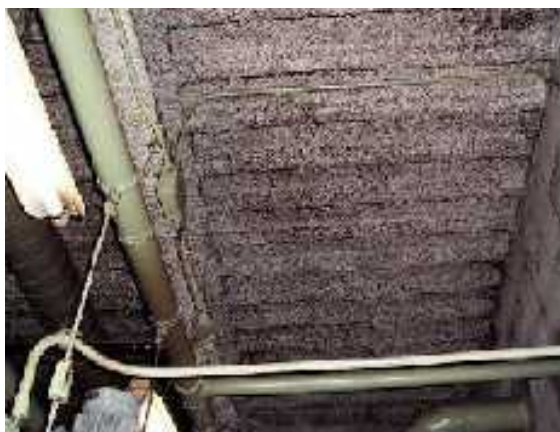
石綿含有吹付けロックウール
