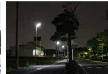
LED化された防犯灯
