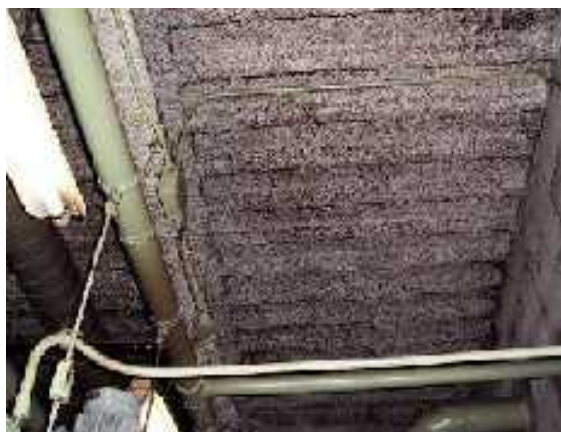
石綿含有吹付けロックウール
