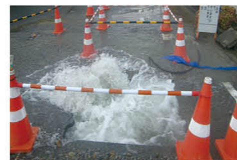
▲老朽化した水道管は漏水事故などの原因に。計画的な更新が必要です
