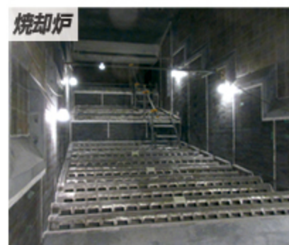
焼却炉 ストーカ式という形態の焼却炉。ごみを移動させながら乾燥・燃焼・後燃焼という3段階の工程で燃やし、効率よく処理します
