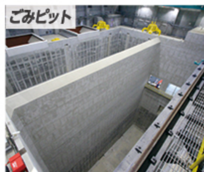
ごみピット ごみピットの容積は約10,600㎡で、深さは約30mあります。1市3町全体のごみを約8日分は貯めることができます
