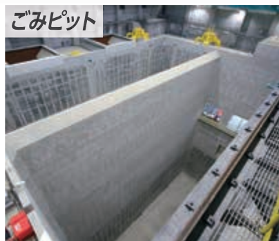
ごみピット ごみピットの容積は約10,600m 3 で、深さは約30mあります。1市3町全体のごみを約8日分は貯めることができます
