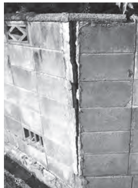
老朽化した塀は事故の危険も
