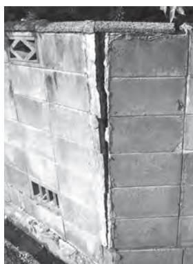
老朽化した塀は事故の危険も
