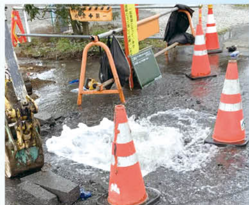
▲水道管の老朽化が進むと漏水し、場合によっては道路が陥没することもあります
