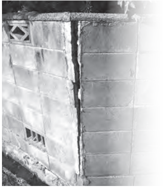
老朽化した塀は事故の危険も
