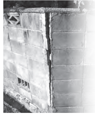
老朽化した塀は事故の危険も
