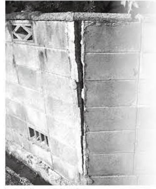
老朽化した塀は事故の危険も
